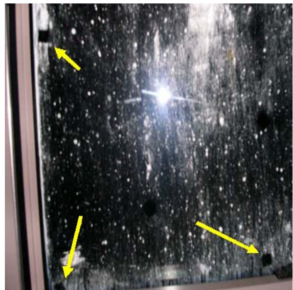
La foto de arriba muestra una ventana instalada con mucha condensación sobre vidrio. Se ven diferentes patrones dentro de la condensación, incluido el contorno de las marcas de la almohadilla separadora en el vidrio. Como arriba, no hay marcas visibles presentes en este vidrio en ausencia de condensación.
