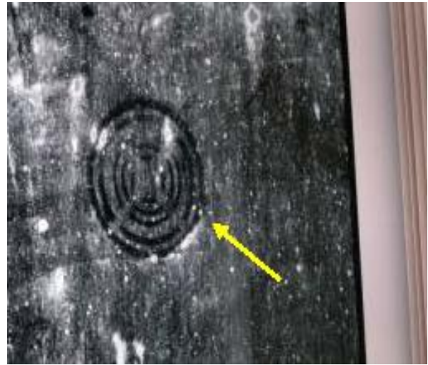
La foto de arriba muestra una ventana instalada con mucha condensación sobre vidrio. Se ven diferentes patrones dentro de la condensación, incluido el contorno de una marca de ventosa que puede haber sido utilizada para manipular el vidrio durante la fabricación o instalación. No hay marcas visibles presentes en este vidrio en ausencia de condensación.
